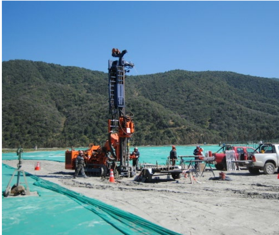
Foto 6 – Sondajes Relaves Minera Florida Figura 1 (der) – Detalle de Sistema Hollow Stem Auger
