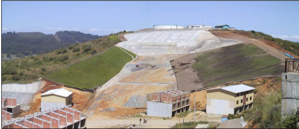
Figura 1. Vista panorámica de la estabilización mediante Soil Nailing del Sector de tanques de abastecimineto ESSBIO. Loteo Lo Galindo
