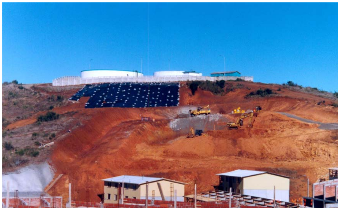
Figura 5. Inicio de trabajos de estabilización luego de retirada gran parte de la masa de suelo deslizada.
